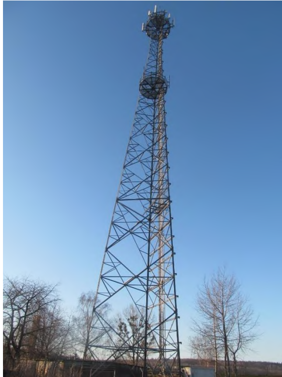
Zał. nr 1: Widok ogólny instalacji radiokomunikacyjnej.
