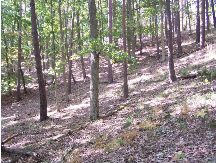
Górna część osuwiska.
