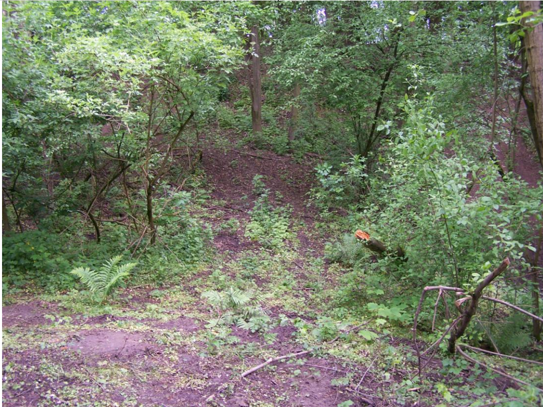
Widok na fragment osuwiska.
