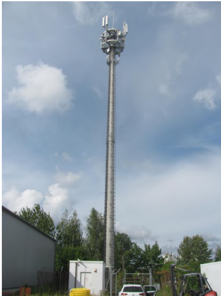
Zał. nr 1: Widok ogólny instalacji radiokomunikacyjnej.
