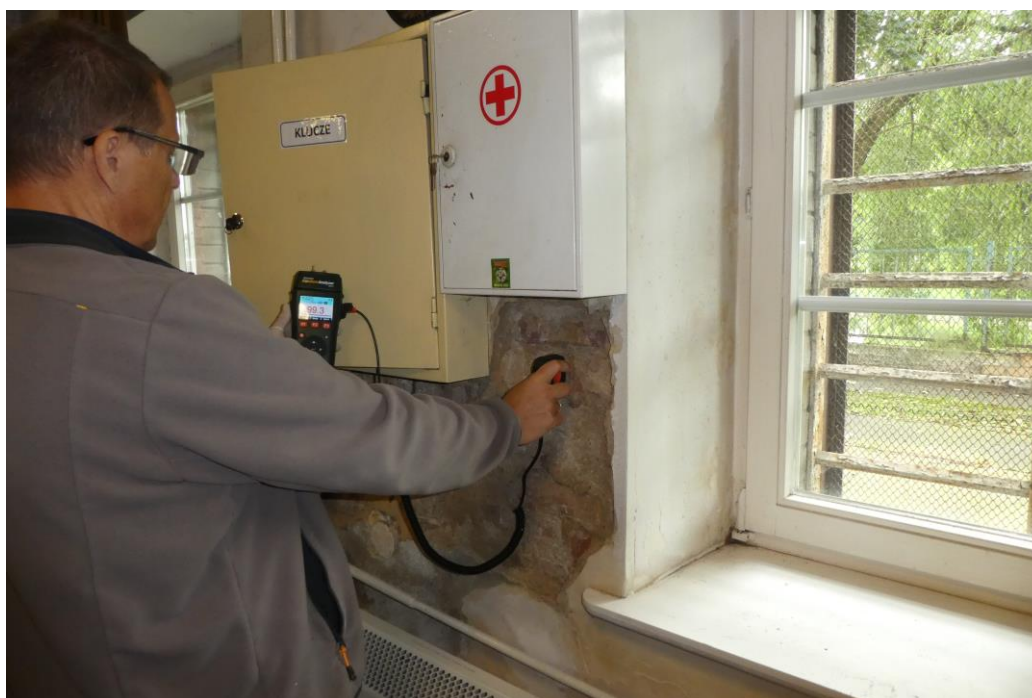
Fot. Pomiar wilgotności ściany w pomieszczeniu nr 018: 99,3%
