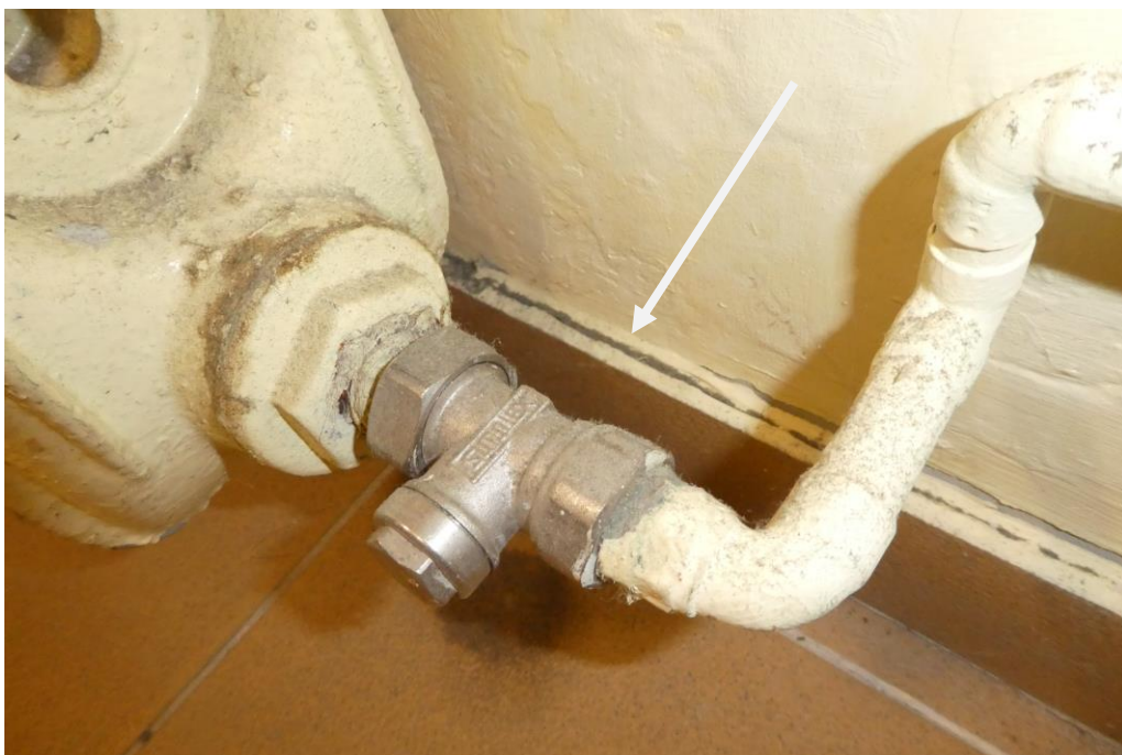
Fot. Zawilgocenia dolnych partii ścian powodują odparzenia cokolików z płytek ceramicznych Wydział Komunikacji
