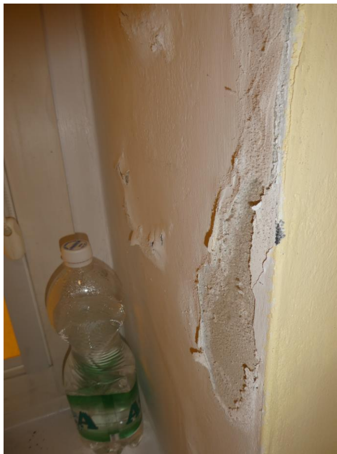
Fot. Zawilgocona (wysolenia, osypujące farby i tynk) ściana w pomieszczeniu nr 020 archiwum
