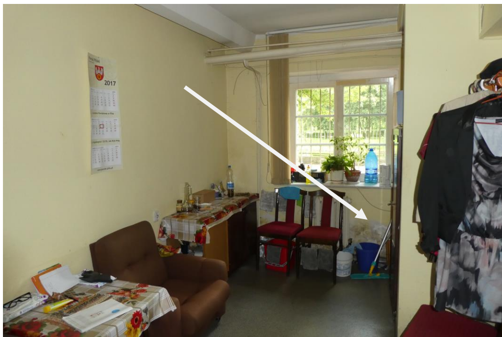
Fot. Zawilgocona ściana w pomieszczeniu 014
