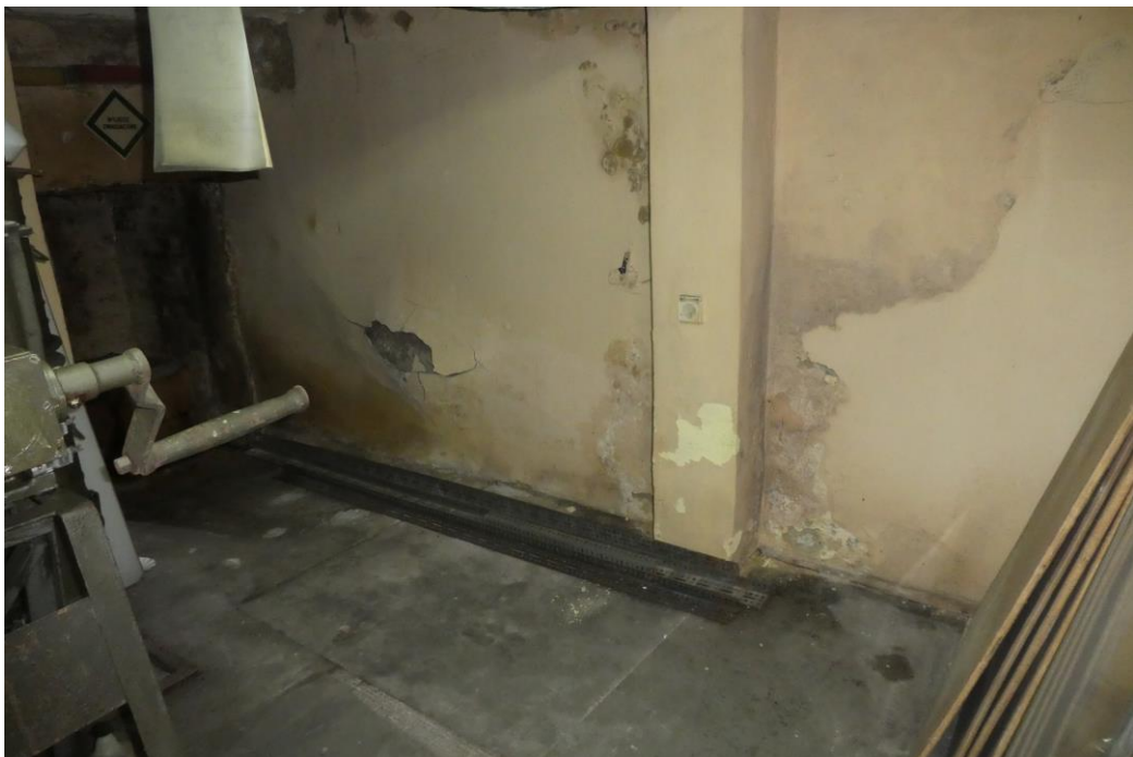
Fot. Korozja biologiczna ściany zewnętrznej w schronie – skrzydło północne
