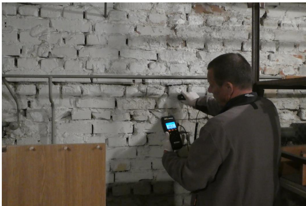
Fot. Pomiar wilgotności względnej ściany zewnętrznej w pomieszczeniu 004 99,3%
