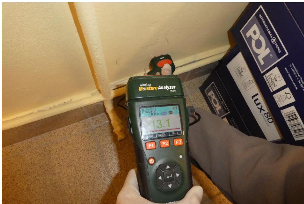
Fot. Pomiar wilgotności nad cokolikiem z płytek pom. j.w.
