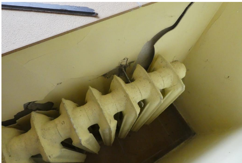
Fot. Odparzone farby, sypiące tynki na ścianie zewnętrznej w archiwum pom. nr 16 Wydział Komunikacji
