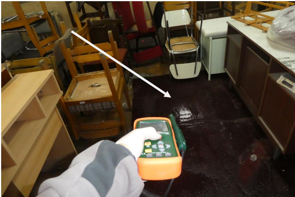
Fot. Woda na wykładzinie w pomieszczeniu j.w.
