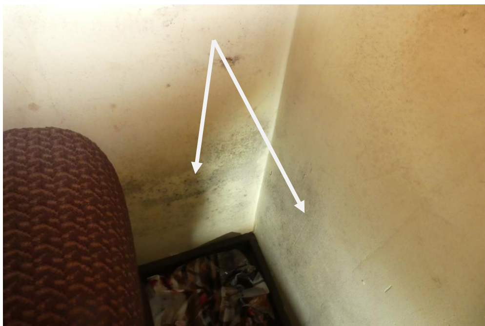
Fot. Kolonie grzybów pleśniowych w pomieszczeniu nr 018
