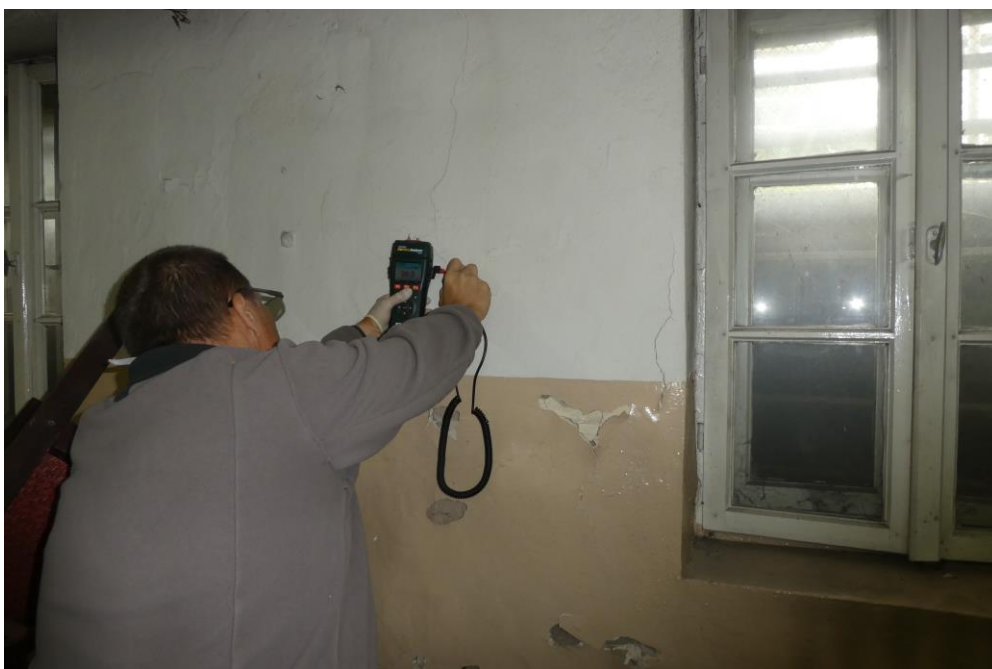
Fot. Pomiar wilgotności względnej ściany zewnętrznej w pom. 006: 99,3%
