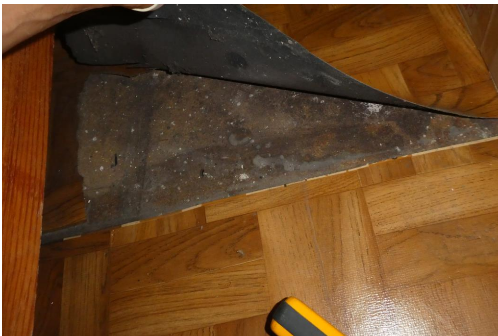
Fot. Grzyby pleśniowe pod wykładziną podłogową
