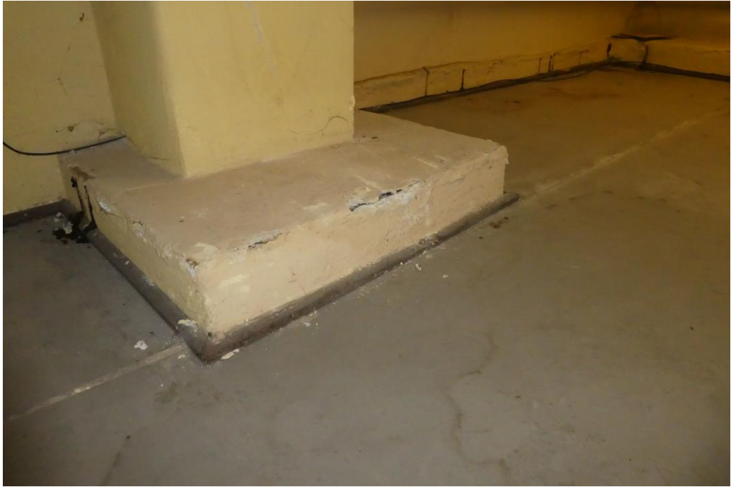
Fot. Odparzone tynki na mokrej ławie fundamentowej – pomieszczenie WIOC
