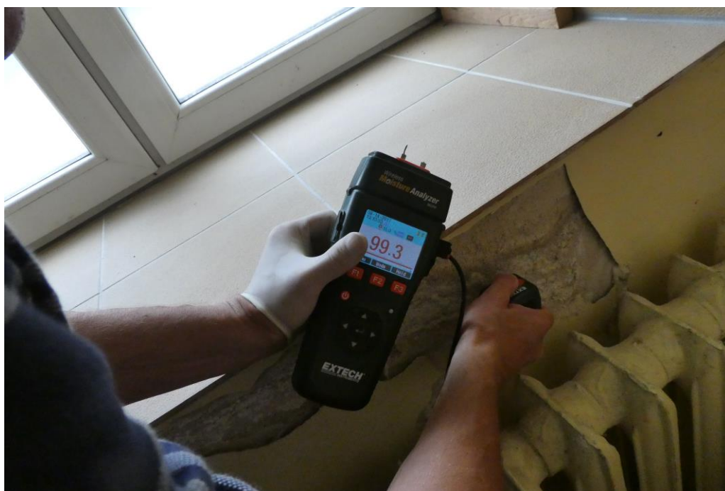
Fot. Badanie wilgotności ściany zewnętrznej w pom. 16: 99,3%
