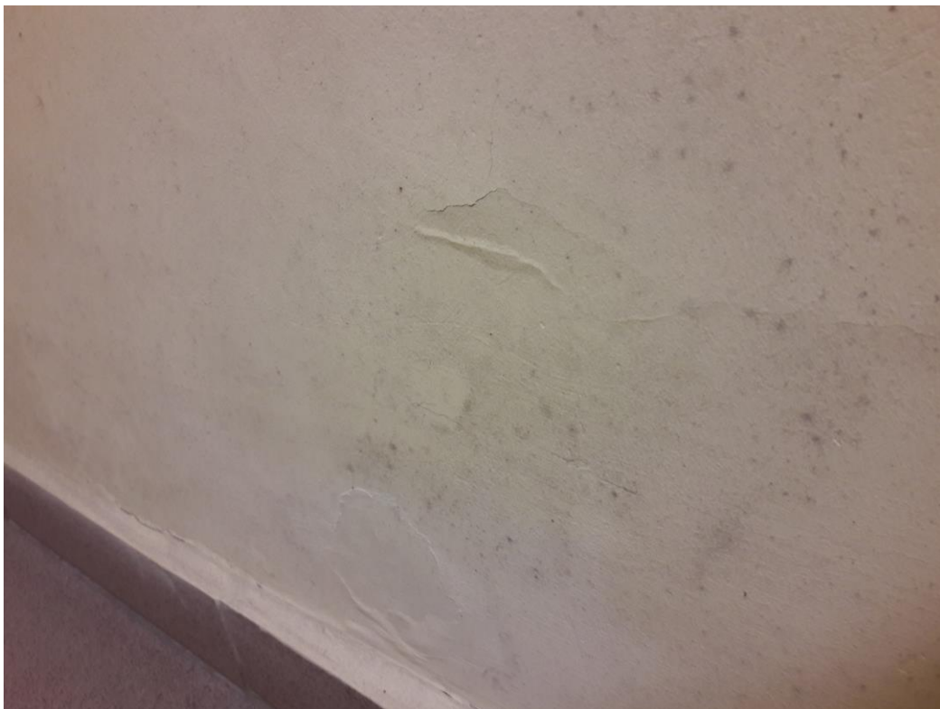
Fot. Grzyby pleśniowe na dolnych partiach ścian na korytarzu w budynku głównym
