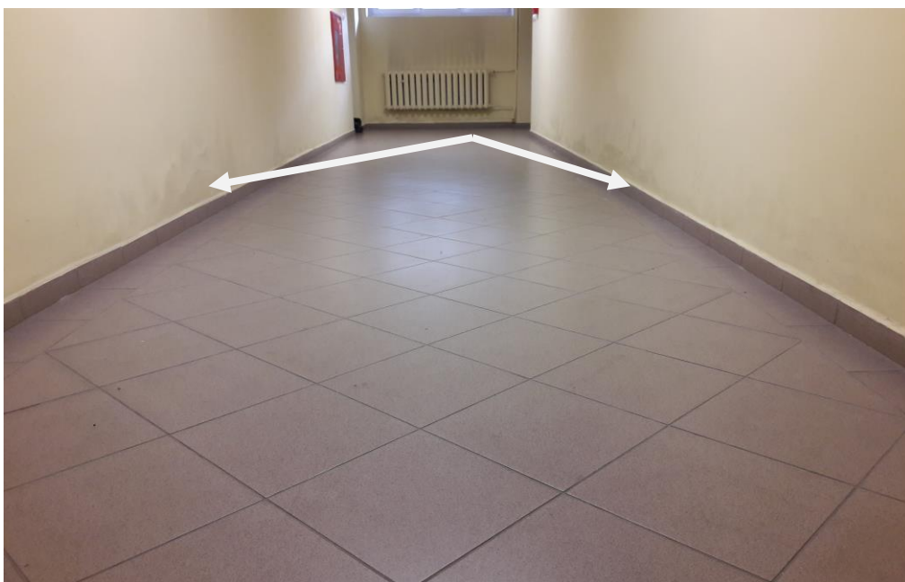
Fot. Zawilgocone dolne partie ścian na korytarzu w budynku głównym
