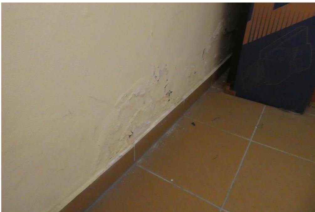
Fot. Zawilgocenia dolnej partii ściany pom. nr 2 Wydział Komunikacji
