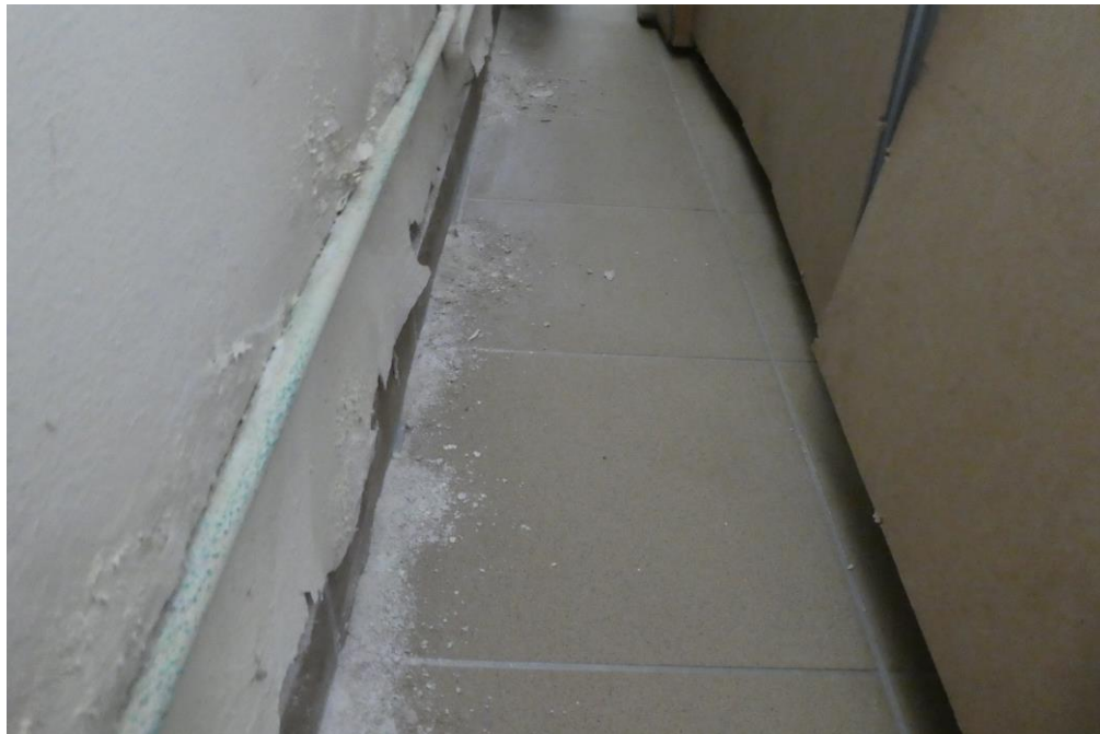
Fot. j.w. widoczna także sól, sypiąca farba, tynk na podłodze. Wypaczone od wilgoci płyty tylne regałów
