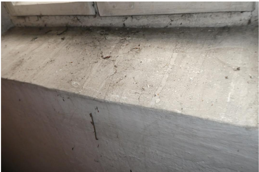
Fot. Zacieki przy oknie pom. j.w.
