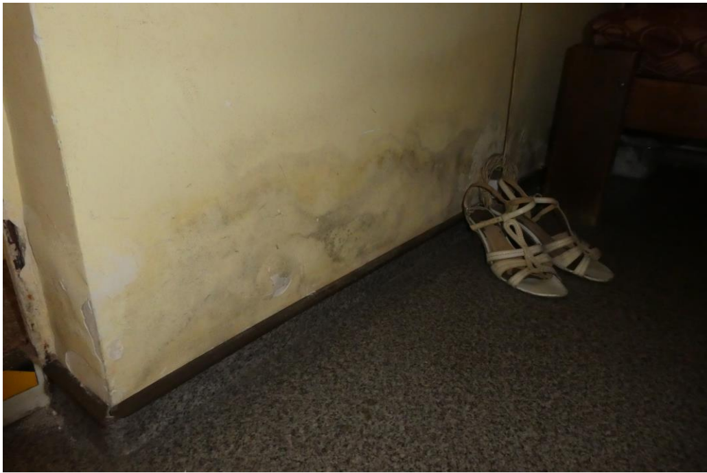
Fot. Zawilgocona, zagrzybiona ściana wewnętrzna od strony korytarza – pom.014
