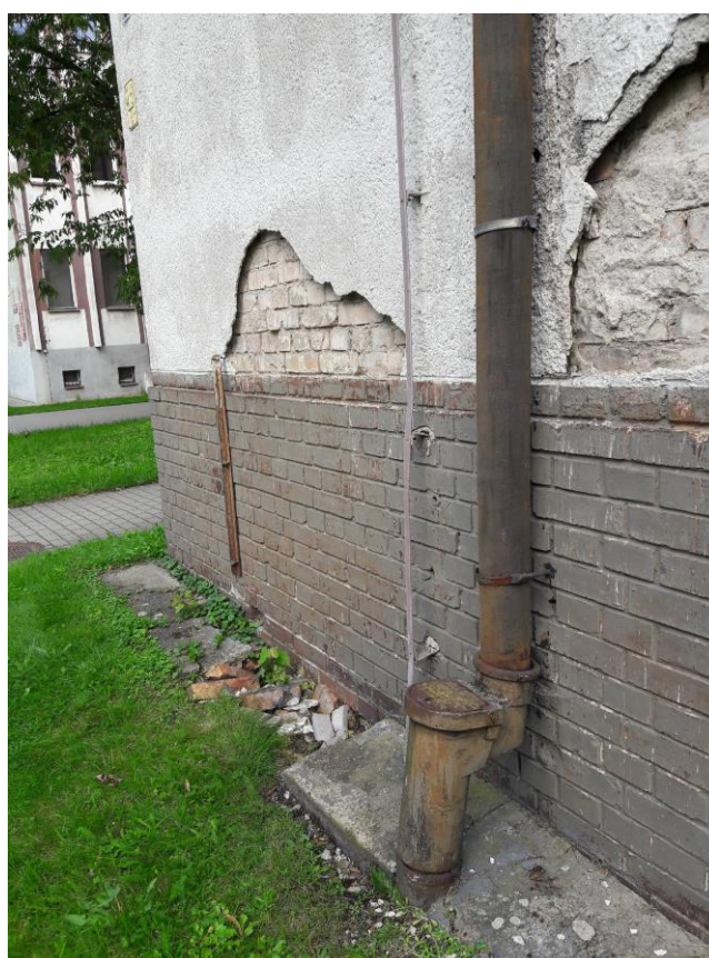
Fot. Odparzenia tynku elewacji na zawilgoconej ścianie, ubytki opaski betonowej i zardzewiała rura spustowa, z której zalewana jest ściana piwniczna
