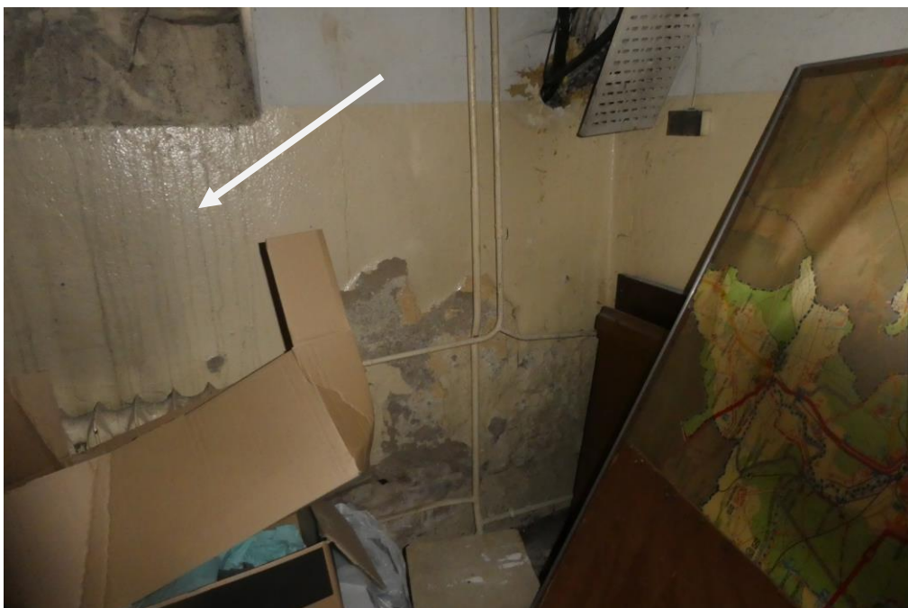
Fot. Mokra ściana zewnętrzna w pom. 007. Zaznaczono zacieki z okna
