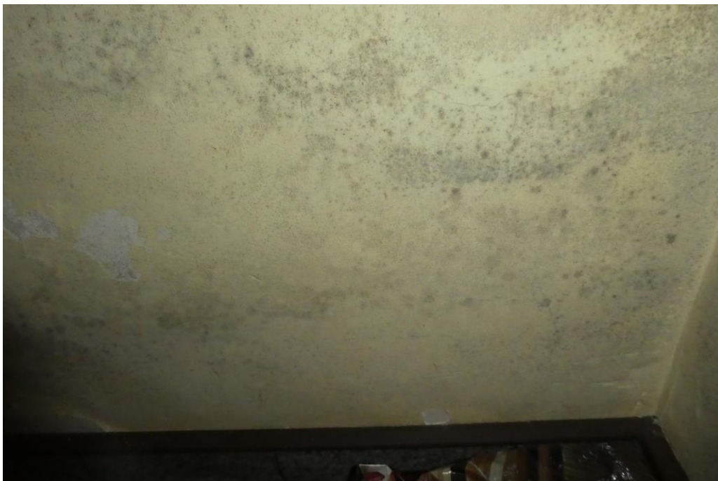
Fot. Grzyby pleśniowe ściana w pom. 014
