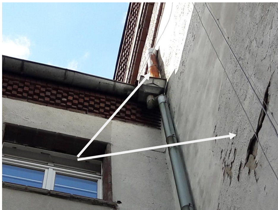
Fot. Zardzewiała rura spustowa, zawilgocona elewacja
