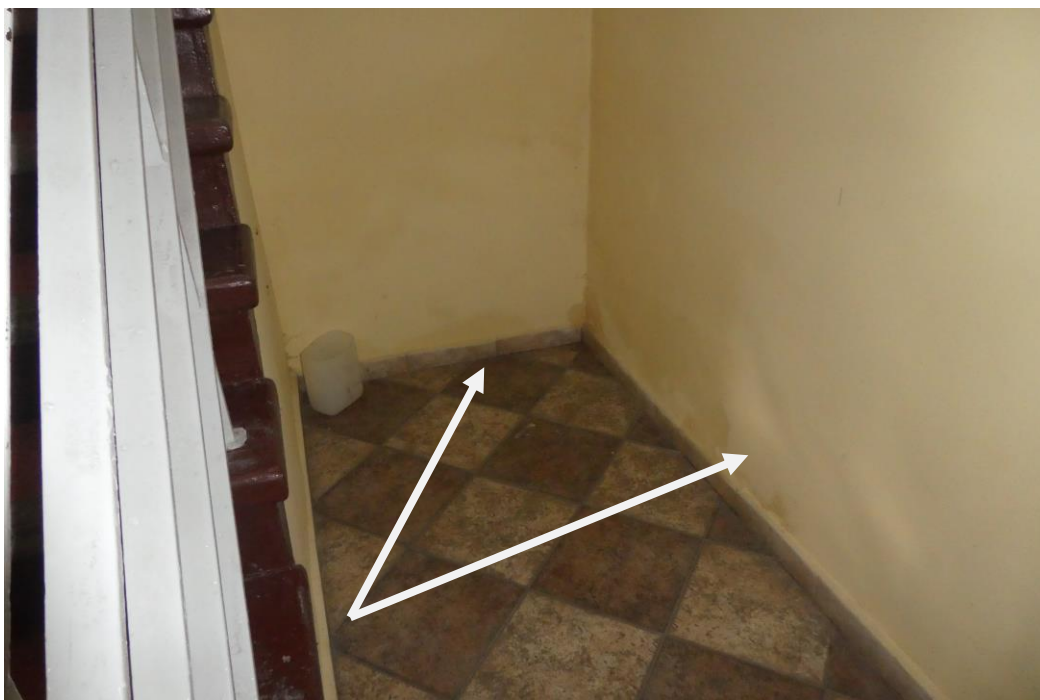
Fot. Spuchnięte tynki, plamy wilgoci na ścianach w klatce schodowej przy pom. 001
