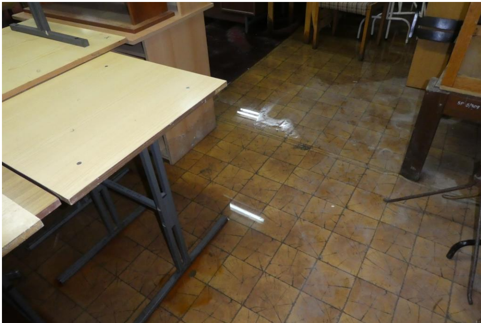
Fot. Woda na posadzce w pom. 006
