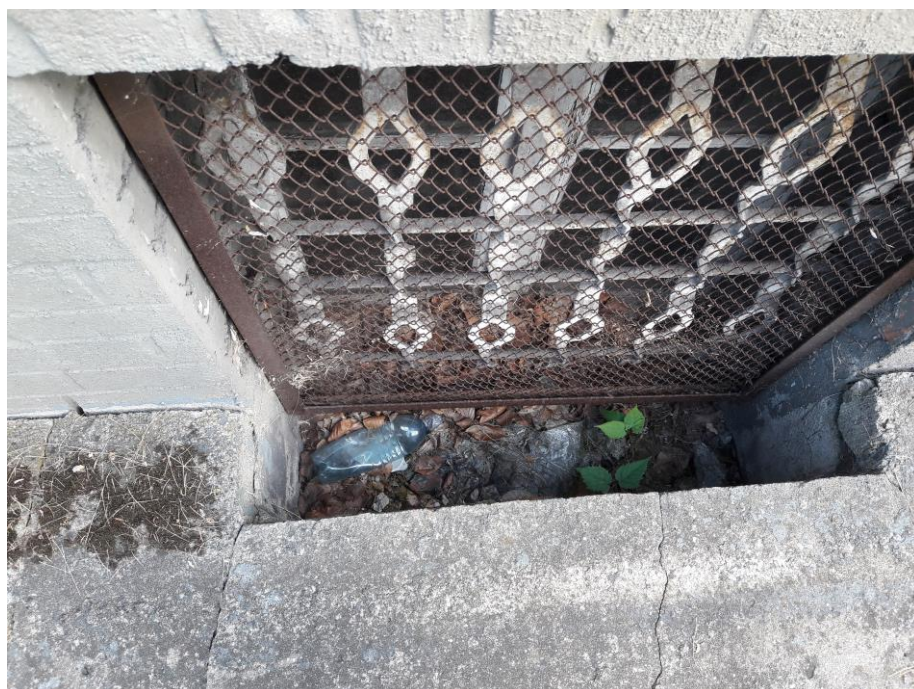
Fot. Nieczyszczone naświetla okienne
