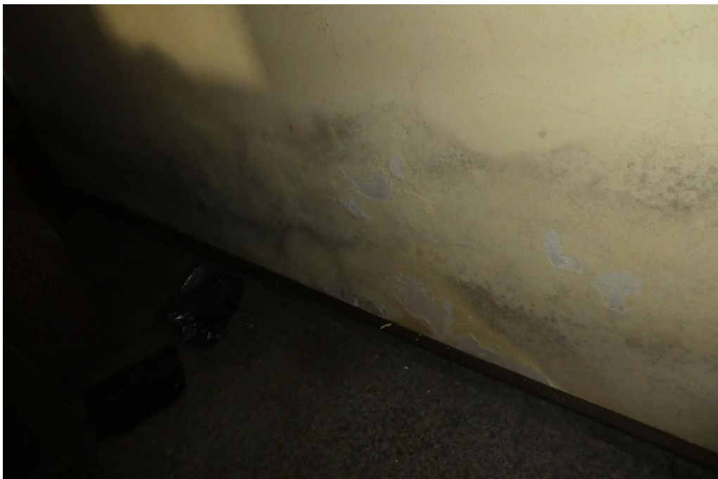
Fot. Zawilgocona, zagrzybiona (grzyby pleśniowe) ściana wewnętrzna – pom. 014
