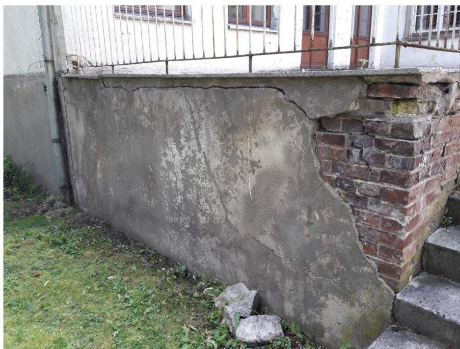
Fot. Zawilgocony taras od strony północnej
