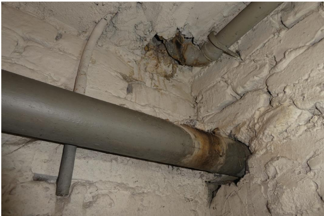
Fot. Przeciekające rury kanalizacyjne – pom. j.w.
