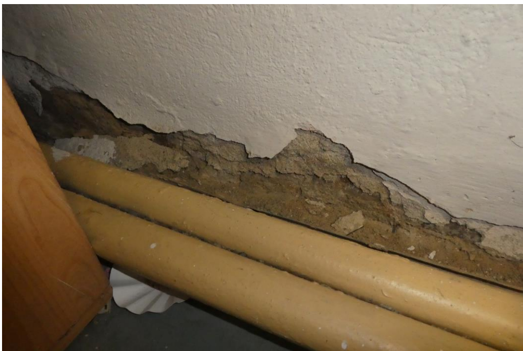
Fot. Osypujący tynk, farba pom. j.w.
