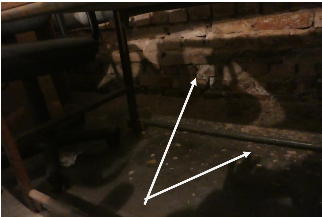
Fot. Sypiące cegły w pomieszczeniu 004
