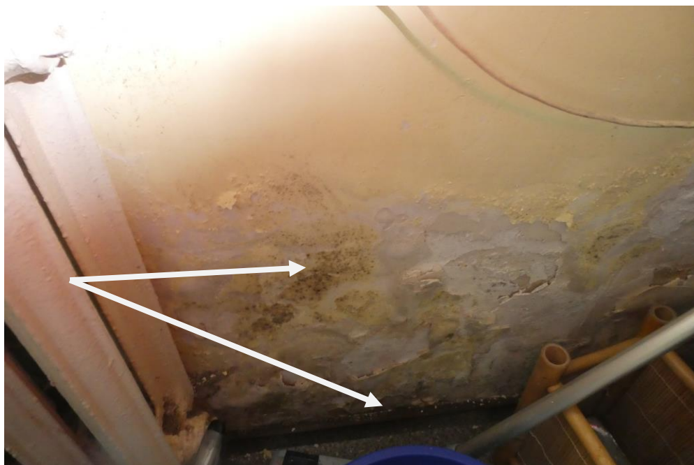
Fot. Kolonie grzybów pleśniowych w pomieszczeniu nr 018
