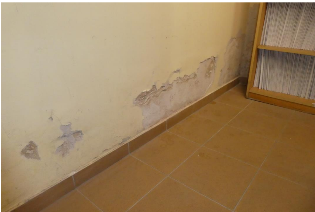
Fot. Zawilgocona ściana w pom. nr 12 w Wydziale Komunikacji
