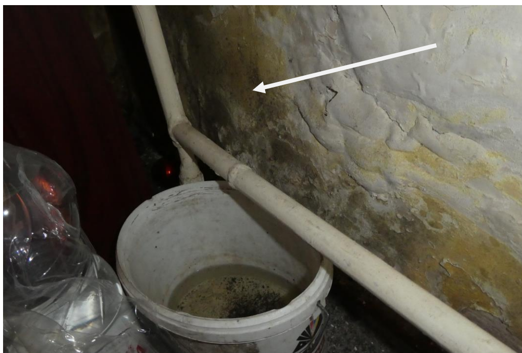
Fot. Mokra ściana zewnętrzna ,spuchnięte tynki, osypująca farba. Oznaczono kolonie grzybów pleśniowych pom. 014
