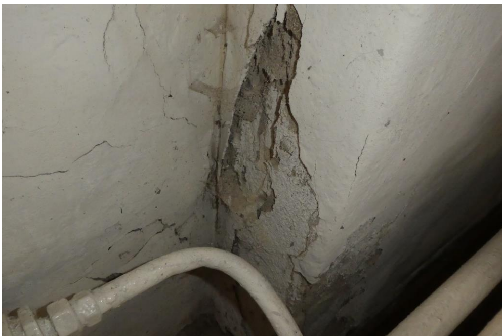
Fot. Osypujące farby, tynki – pom. j.w.
