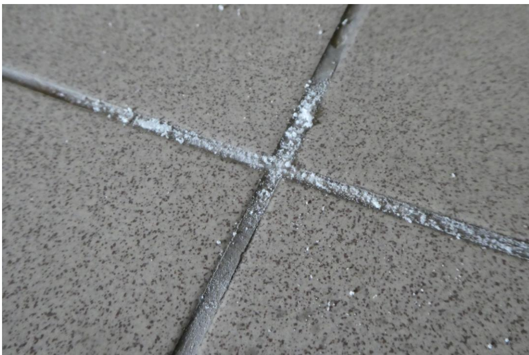
Fot. Sól na spoinach płytek – korytarz 15a
