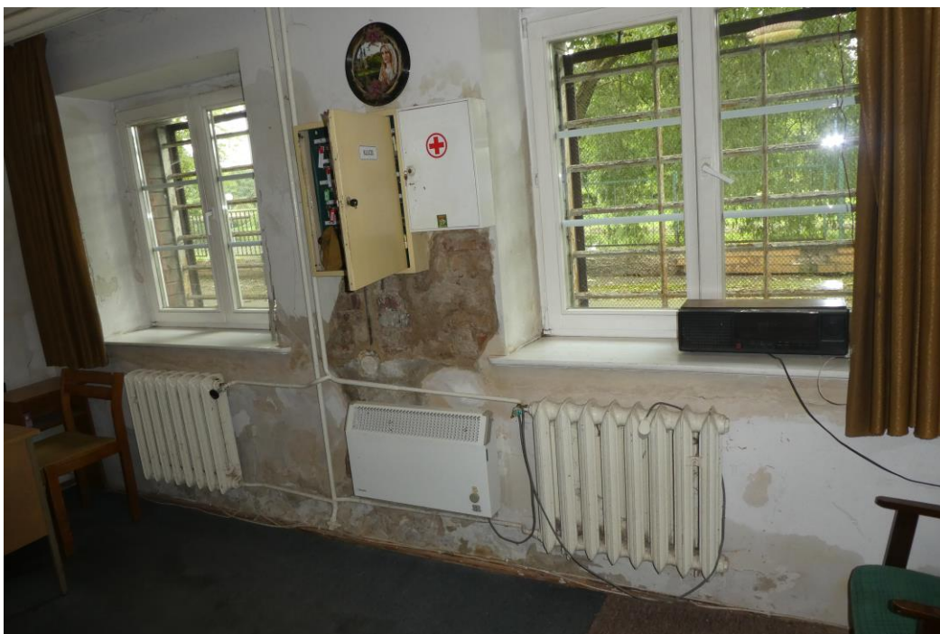
Fot. Mokra ściana zewnętrzna w pomieszczeniu konserwatora nr 018 (zacieki, brak tynków, osypujące farby itd.)
