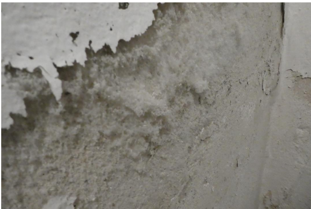
Fot. Zasolenia na ścianie w pom. 001
