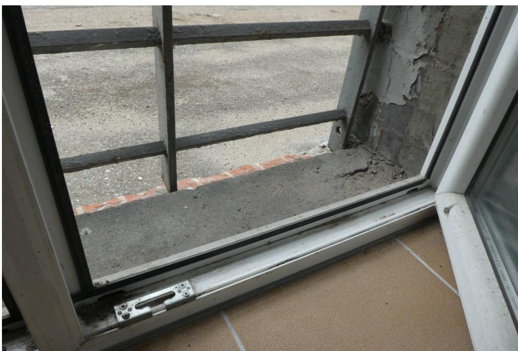
Fot. Brak wykończenia parapetów pom. 16
