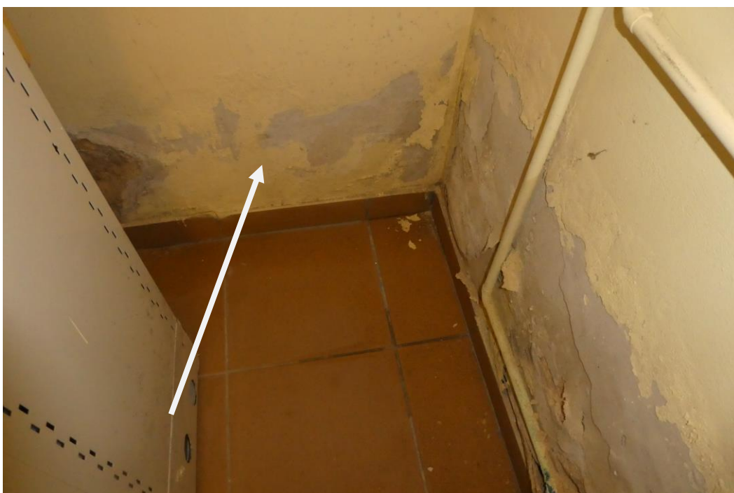
Fot. Zawilgocenia ściany wewnętrznej w pom. 13 archiwum Wydział Komunikacji
