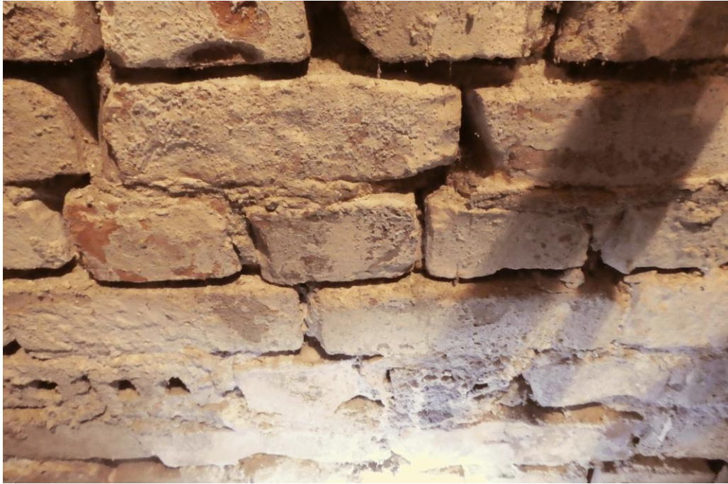
Fot. Ubytki w spoinach, cegły dziurawki w ścianie zewnętrznej – pom. j.w.
