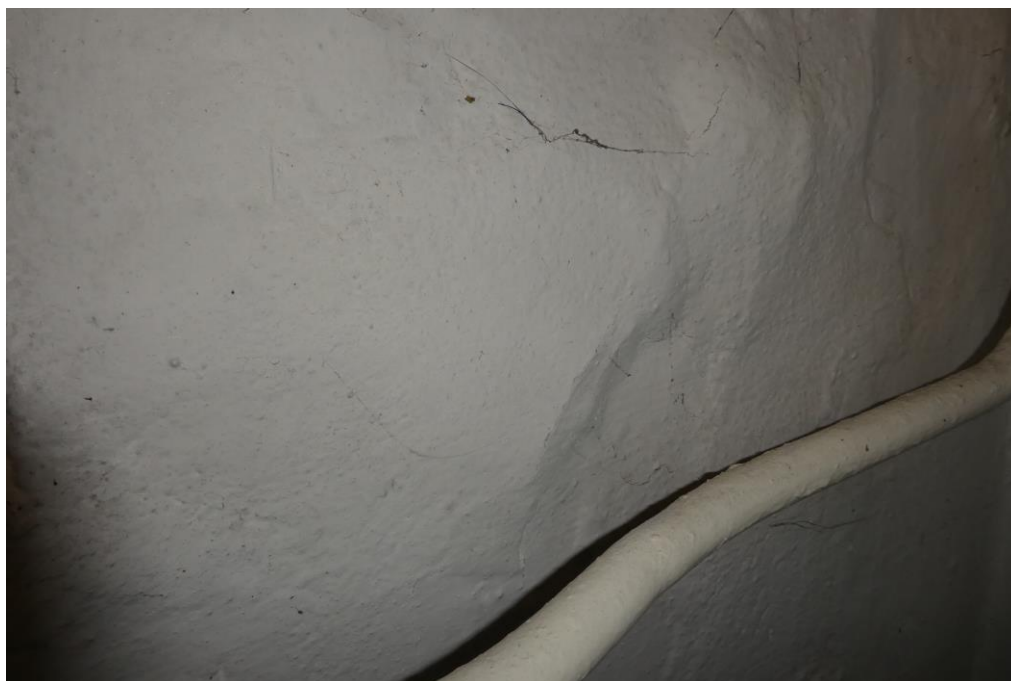
Fot. Spuchnięty tynk na mokrej ścianie zewnętrznej – archiwum PUP
