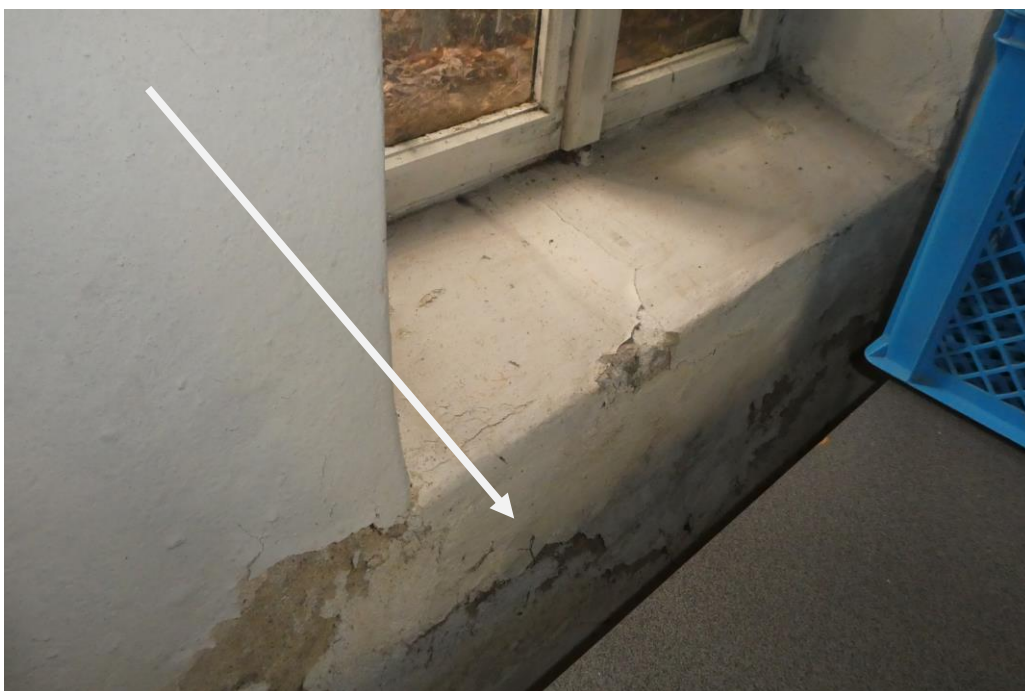
Fot. Mokra ściana zewn. od strony wejścia głównego do budynku Starostwa Powiatowego – Archiwum PUP
