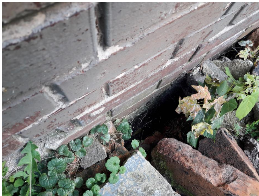
Fot. Wyflukana dziura przy ścianie piwnicznej
