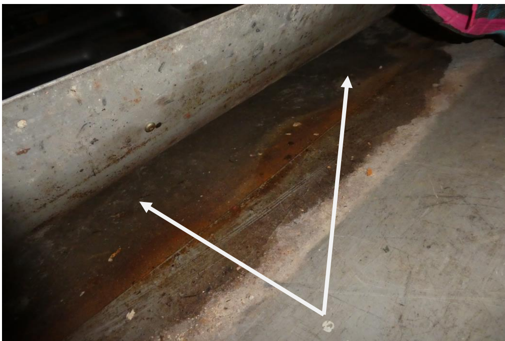
Fot, Mokra posadzka pod wykładzina w pomieszczeniu nr 004. Zaznaczono kolonie grzybów pleśniowych
