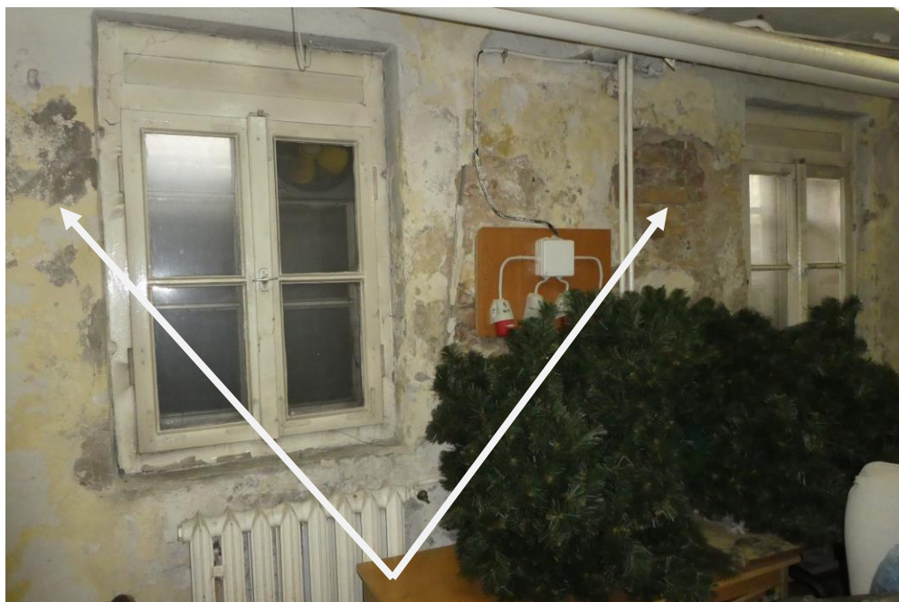
Fot. Mokra ściana zewnętrzna w jednym z pomieszczeń 006
