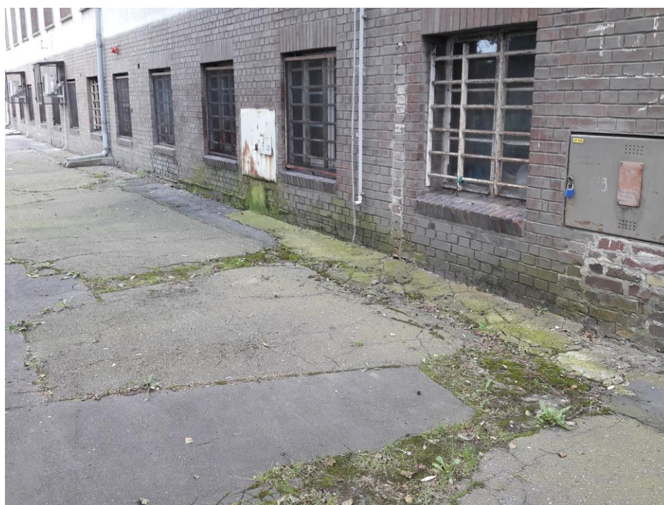
Fot. Mech i glony wskazujące na zalewanie ścian piwnicznych z dachu
