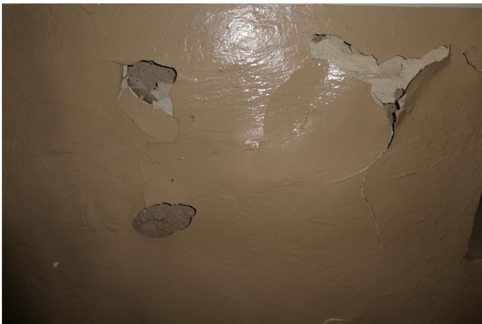
Fot. Zawilgocone, spuchnięte tynki w jednym z pomieszczeń 006
