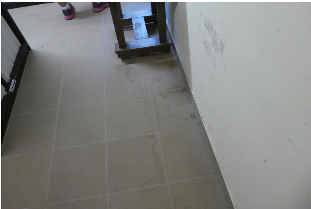
Fot. Zacieki na posadzce w archiwum pom. 16 – Wydział Komunikacji
