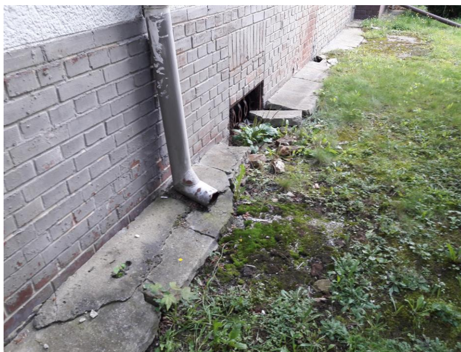
Fot. Zbyt krótkie odprowadzenie wody opadowej spowodowało wypłukanie opaski i naświetla
