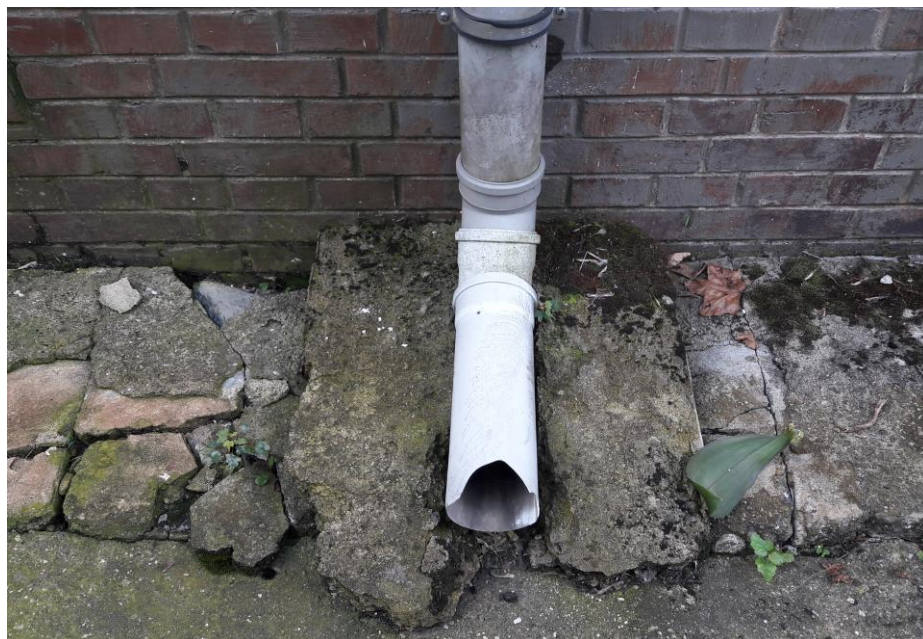
Fot. Spękana opaska betonowo-asfaltowa z krótkim odprowadzeniem wód opadowych od strony rzeki
